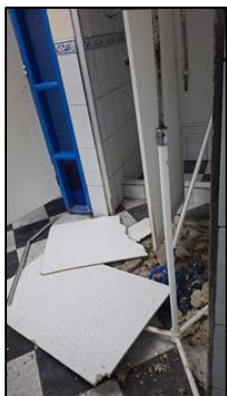
Colapso del techo falso (cielo raso)
